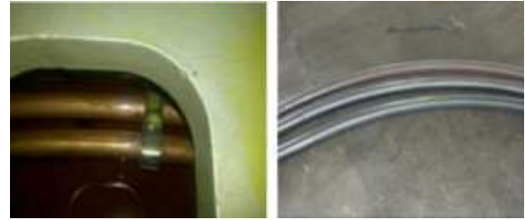
Fig. 1. Tuberías del sistema de enfriamiento.
