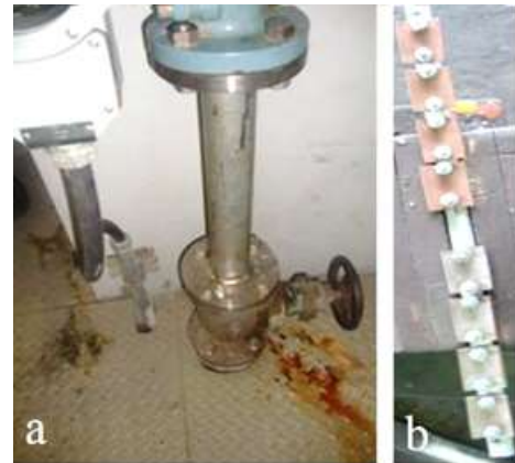
Fig. 2. (a) Tubería de salida del agua de enfriamiento y (b) cupones.
